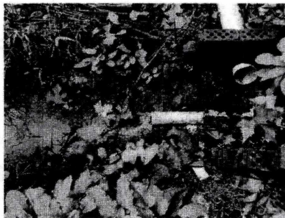
FIGURA 2 – SAÍDA DE ESGOTO DAS CASAS
